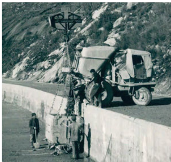
Figura 120. Dumper llenando el cazo en el muelle de carga. A. Martí. ADC.
