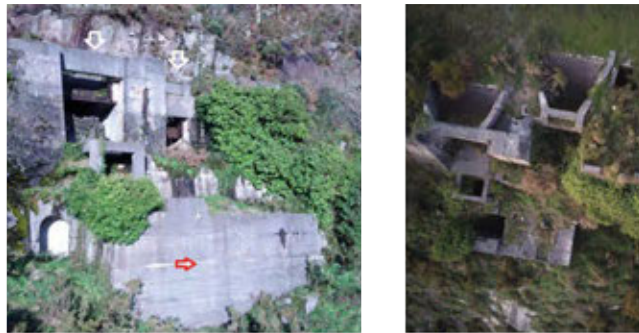
Figuras 104 y 105. Situación actual de la estructura de las machacadoras primarias en alzado y planta. D. Couce.
